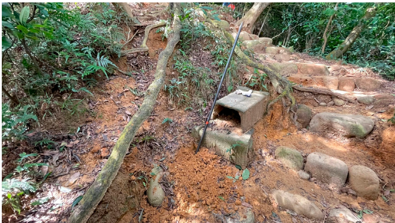
▲ 邊坡冲刷樹根裸露施工前
